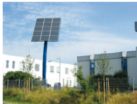
Strom aus Sonnenlicht durch Solarpaneele: Conergy in Groß Machnow zeigt sein Produkt.
