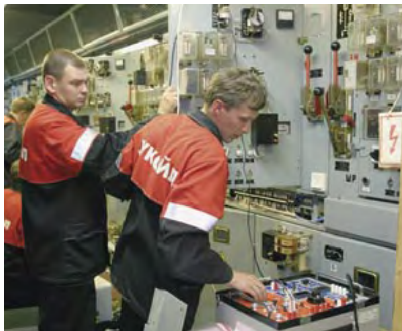
Im Leitstand einer Erdölförderanlage von Lukoil
